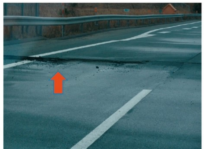
亀裂が入っている東北自動車道
